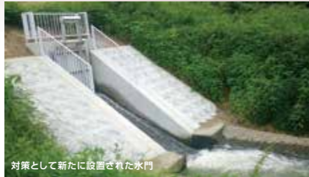
対策として新たに設置された水門
